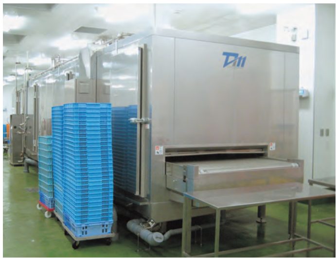
第2加工室に導入したOSJ型トンネルフリーザー
